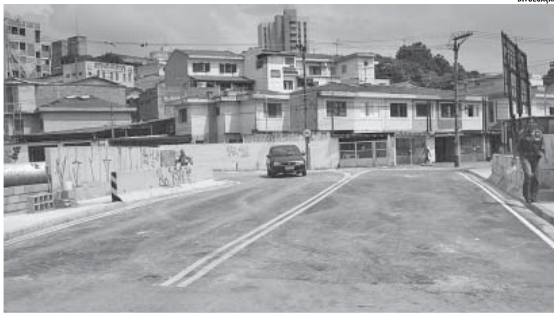
Ponte João Ducin é liberada para o trânsito, em tempo recorde, após 45 dias de obras
